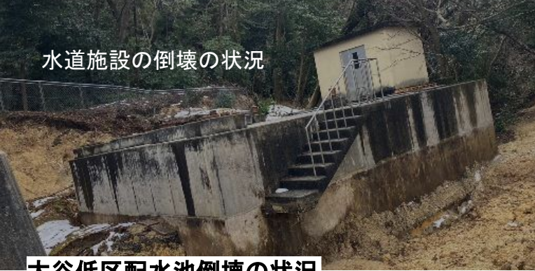
大谷低区配水池倒壊の状況
